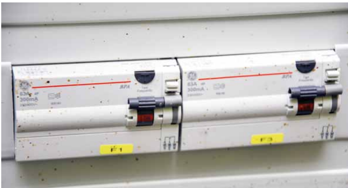
Vikavirtasuojan toiminta tulee testata määrävälein.
