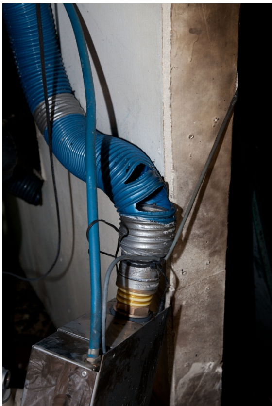
Kuva 4. "Kurkkuletku" täyttöpaneelin ja kompressorin välissä
