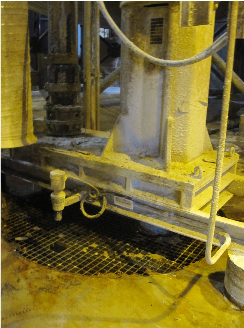
Kuva 8. Lattiakaivo, johon valunut kalkkikiviliete pumpattiin esineutraloinnin 1-linjan varastosäiliöön.
