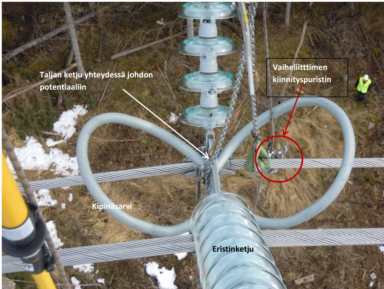
Kuva 5. Työkohte onnettomuuden jäljiltä 18.4.2013.
