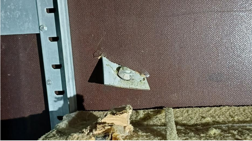
Kuva 12. Kontin oven läpäissyt ja takaseinän vaneriin uponnut metallikappale.
