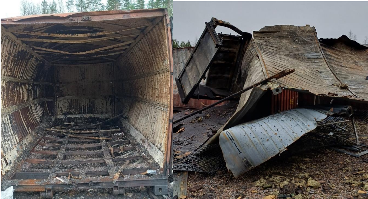
Kuva 10 (vasen). Suurin osa konteista säilytti muotonsa tai pullistui sisäisen paineen vaikutuksesta.
