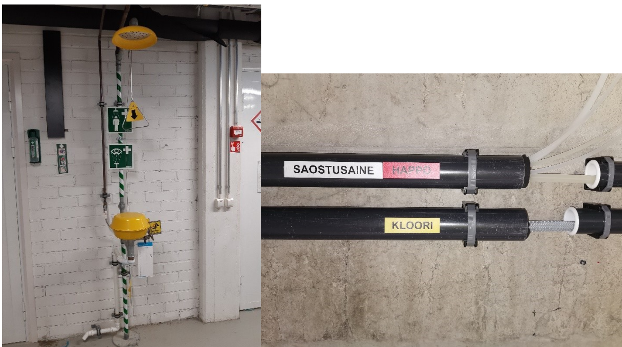
Kuva 3. Vasemmalla varautumisjärjestelmiä sijoitettuna kemikaaliloihin: silmänhuuhtelupullo, hätäsuihku sekä silmien huuhteluallas. Oikealla kemikaalien siirtolinjastot sijoitettuna muoviputkeen, joka toimii suojana ja helpottaa ripustamista. Merkinnoissa on käytetty kemikaalikohtaisia värejä.
