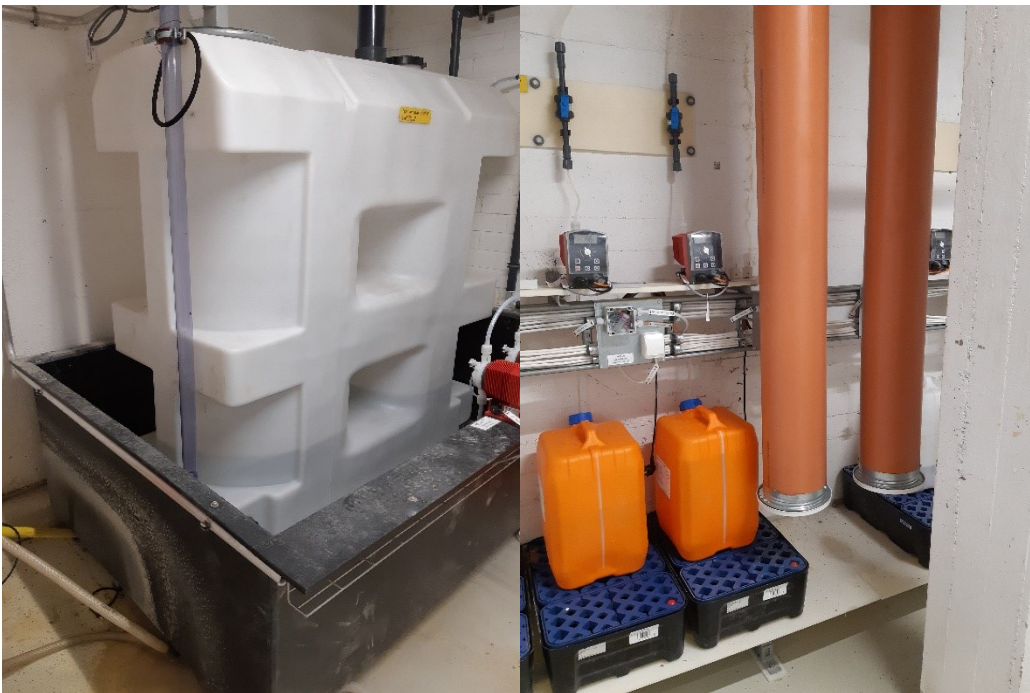
Kuva 1. Vasemmalla natriumhypokloriittisäiliö, ja oikealla rikkihappoastiat kestopuovisissa valumaltaissaan. Rikkihappoastioiden vieressä sijaitsevat poistoilmanvaihtoputket. Sähköasennuksen kotelointi on puutteellinen.
