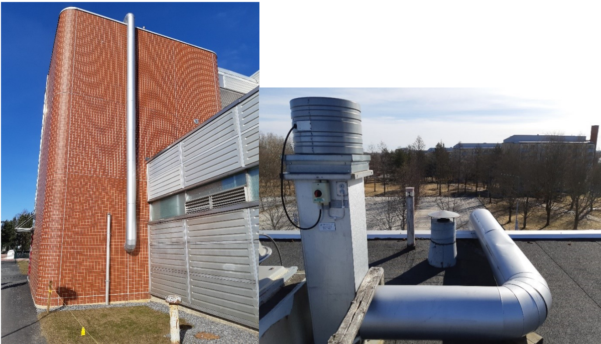
Kuva 5. Kemikaalitulojen poistoilman ulospuhallus järjestettynä uimahallin katolle.
