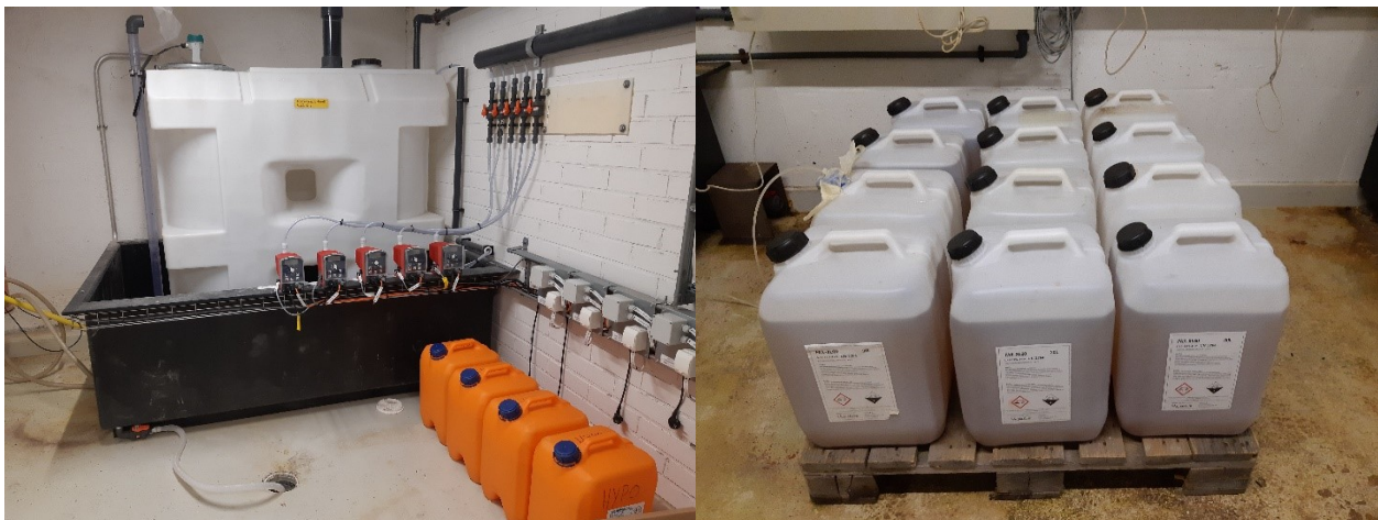
Bild 2. Till vänster en natriumhypokloritbehållare i en avrinningsbassäng. Bassängens tömningsventil är öppen och en slang har letts från ventilen till golvbrunnen. Arrangemanget gör det möjligt för kemikalieläckor att komma ut i avloppet, och därför ska avloppet vara avsett för uppsamling av läckor. Till höger ett exempel på lagring som står i strid med lagstiftningen: fällningskemaliebehållarna har ställts på en lastpall utan avrinningsbassänger.
