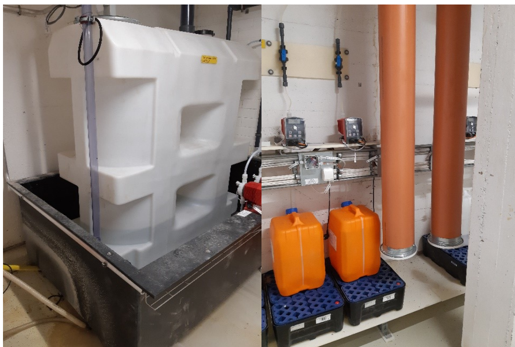
Bild 1. Till vänster en natriumhypokloritbehållare och till höger svavelsyrabehållarna i sina avrinningsbassänger av termoplast. Bredvid svavelsyrabehållarna finns ventilationsrören för avluftning. Elinstallationen är bristfälligt inkapslad.
