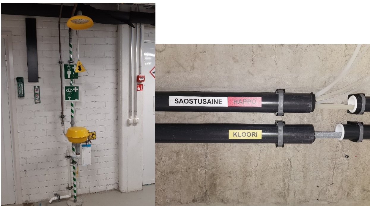
Bild 3. Till vänster beredskapssystem placerade i kemikalielokaler: ögonduschflaska, nöddusch och handfat för sköljning av ögonen. Till höger rörlinjer för kemikalier placerade i ett plaströr som skyddar rörlinjerna och gör det lättare att hänga upp dem. I märkningarna har använts olika färger för olika kemikalier.
