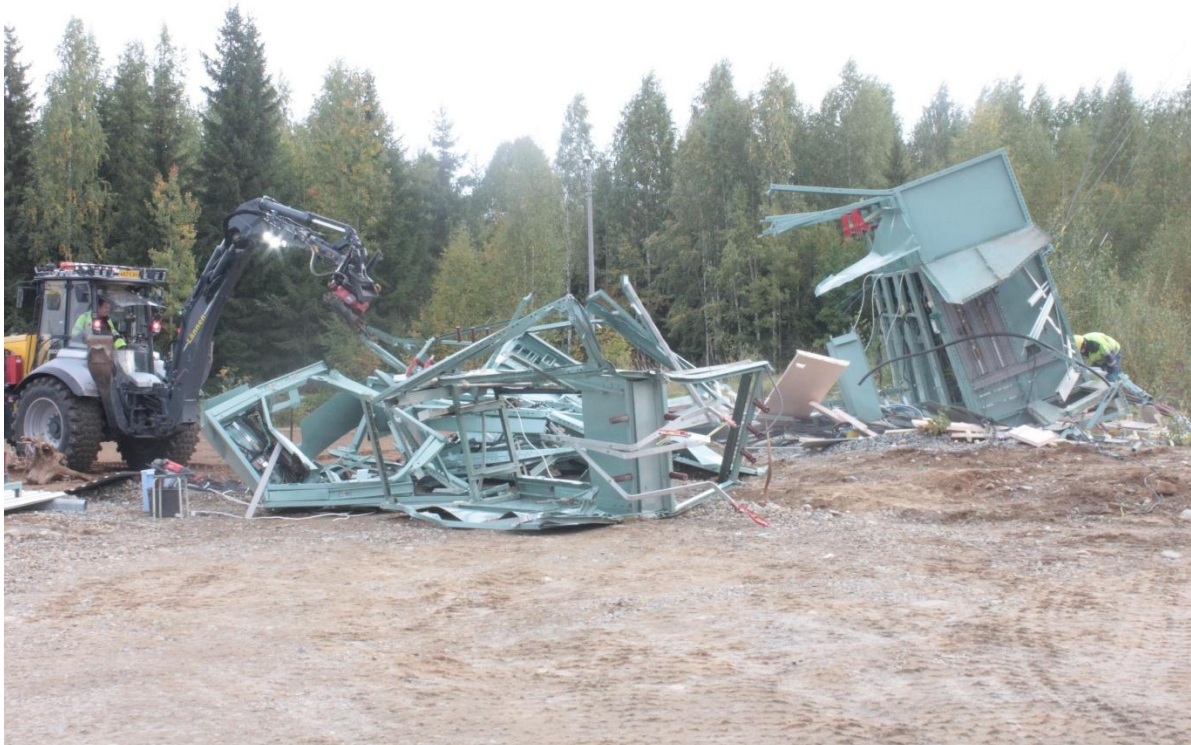
Kuva 24 Vanhana tekniikkana romutettu 20 kV muuntaja
