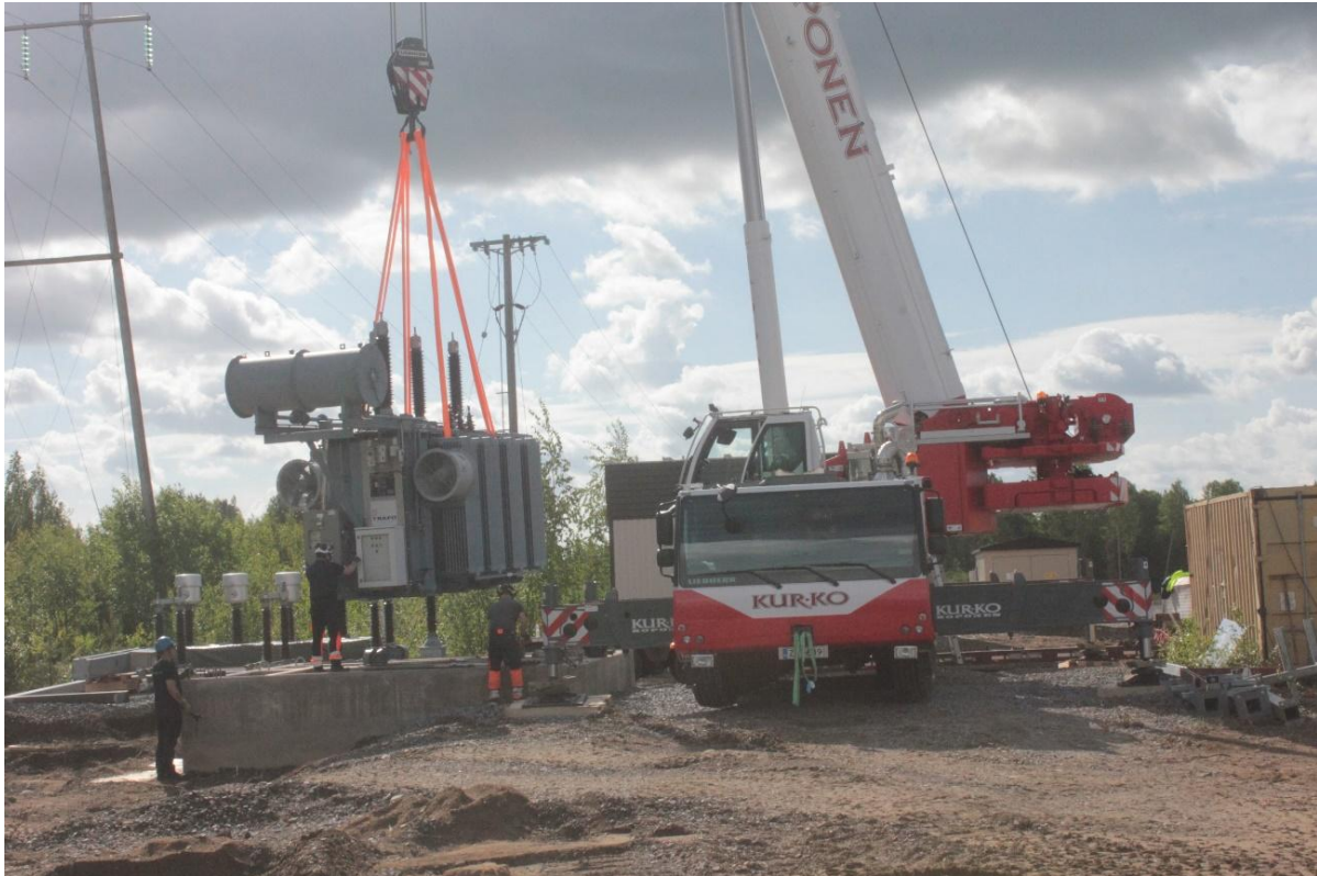
Kuva 23 Myyty 110 kV muuntaja
