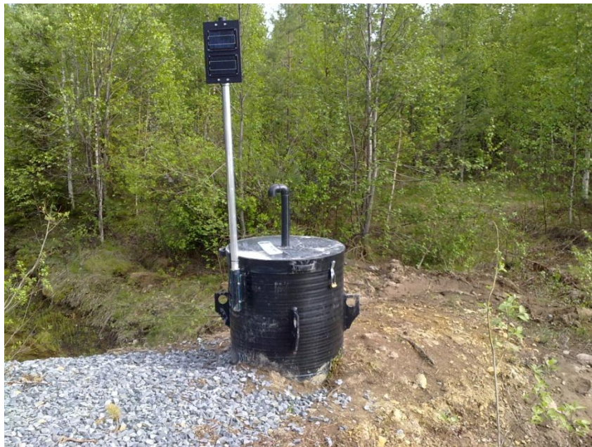
Kuva 8 – Kaivosalueelta lähtevälle ojalle asennettu mittakaivo.
