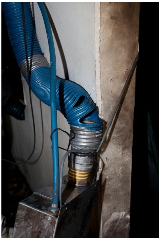
Kuva 4. "Kurkkuletku" täyttöpaneelin ja kompressorin välissä
