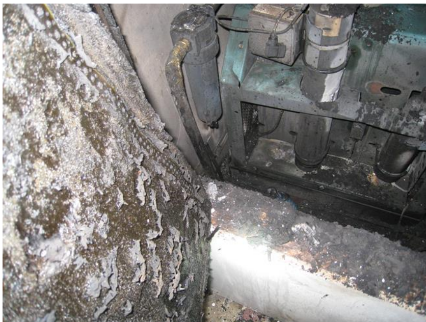
Kuva 6. Kompressorin palaneet öljysuodattimet
