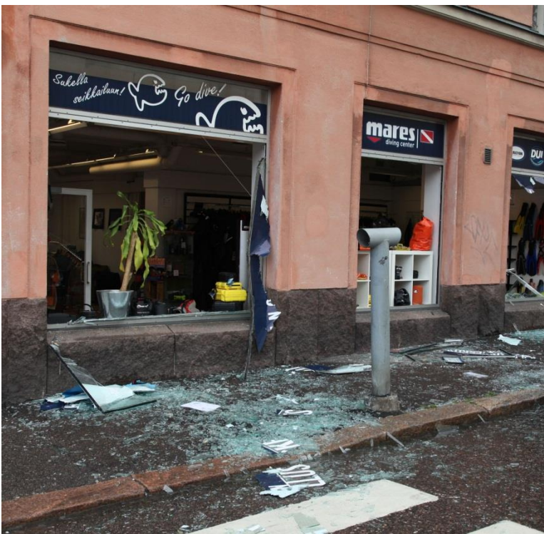
Kuva 3. Onnettomuuspaikan ikkunat ovat hajonneet
