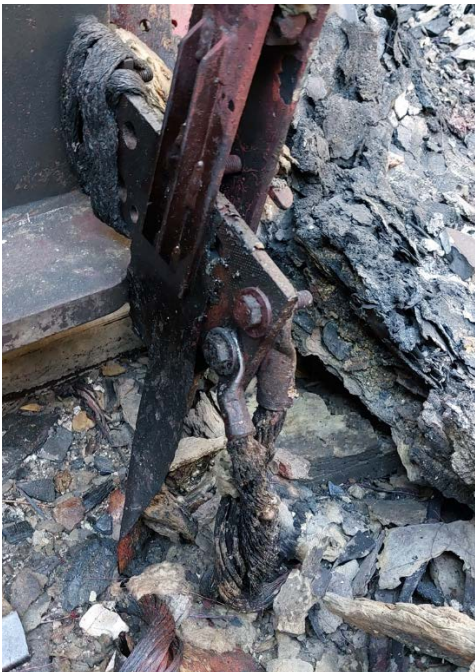
Kuva 3. Kytkenä ollut maadoituskaapeli
