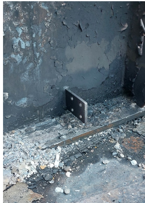
Kuva 4. Korvake, jossa maadoituskaapelin olisi pitänyt olla kiinni
