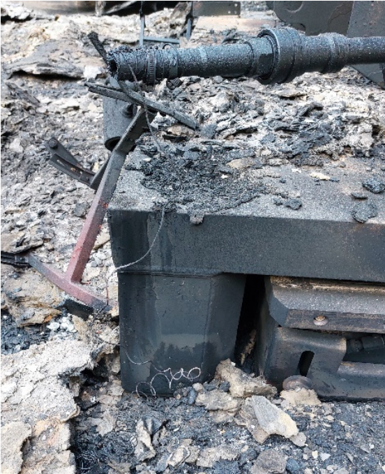
Kuva 14. Reaktorin paisuntaöljyputken suljettu venttiili
