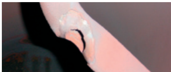
Kulumaa putkiston mutkan alueella
