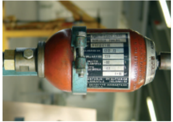
Koneeseen liittyvä paineakku. Paineakun suurin sallittu käyttöpaine voi olla jopa yli 300 baria.
