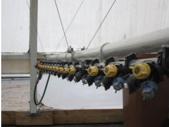
KUVA 15. Suuttimien suoruuden näkee helposti sivusta katsottuna.
