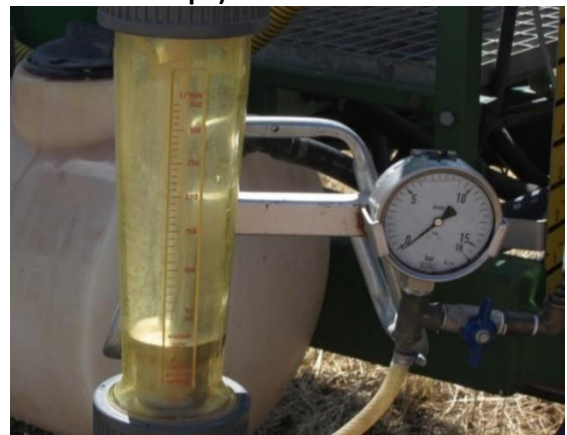
KUVA 14. Pumpun tuoton ja mahdollisen ilmavuodon näkee virtausmittarilla.
