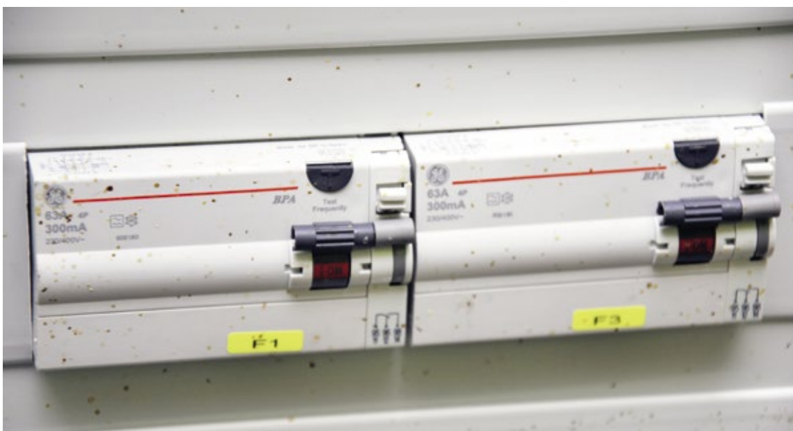
Vikavirtasuojan toiminta tulee testata määrävälein.
