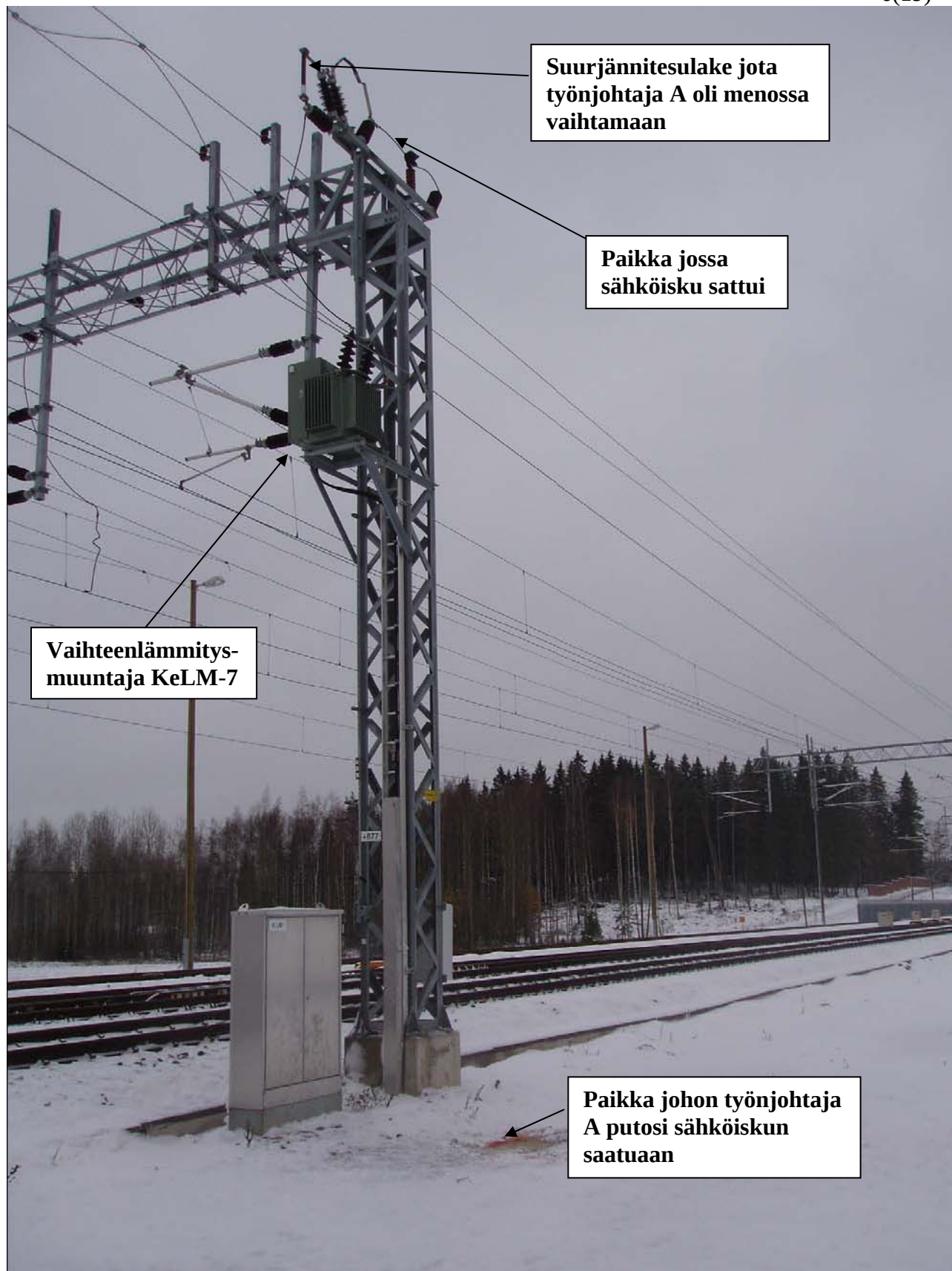
Kuva 3. Portaalipylväs, jolla onnettomuus tapahtui
