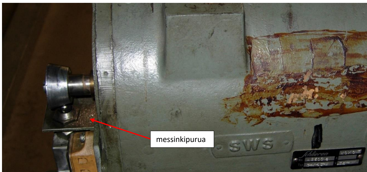
Kuva 6. Akselin messinkisestä liukulaakerista irronnutta purua.
