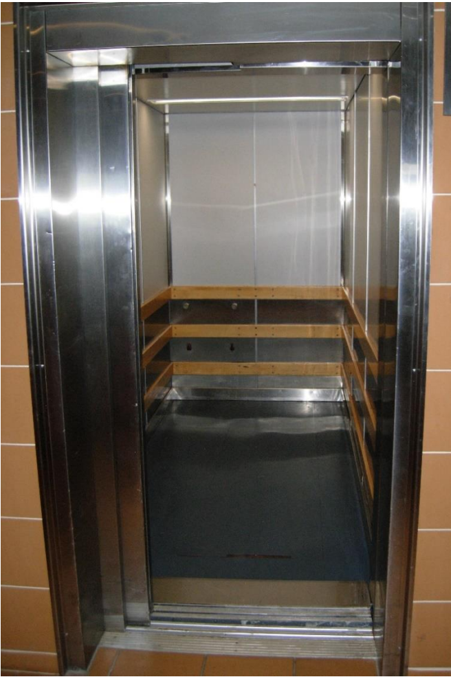
Kuva 1. Hissikori sisältä. Tapaturmahissiä vastaava, vieressä oleva hissi.
