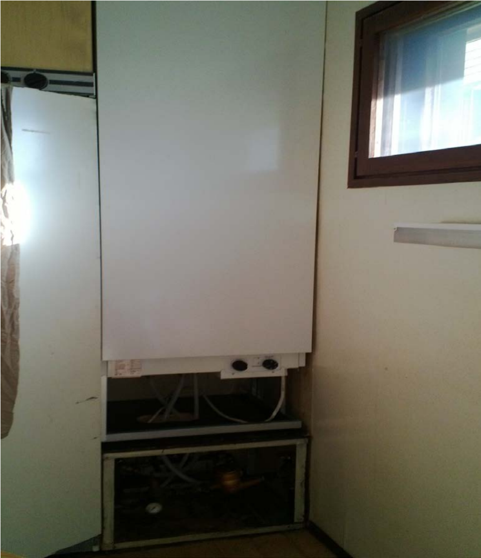
Kuva 1. Lämminvesivaraaja paikalleen asennettuna.
