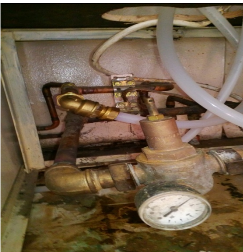
Kuva 2. Lämminvesivaraajan alla olevassa tilassa oleva metallinen vesiputkisto oli maadoitettu kupariköydellä.
