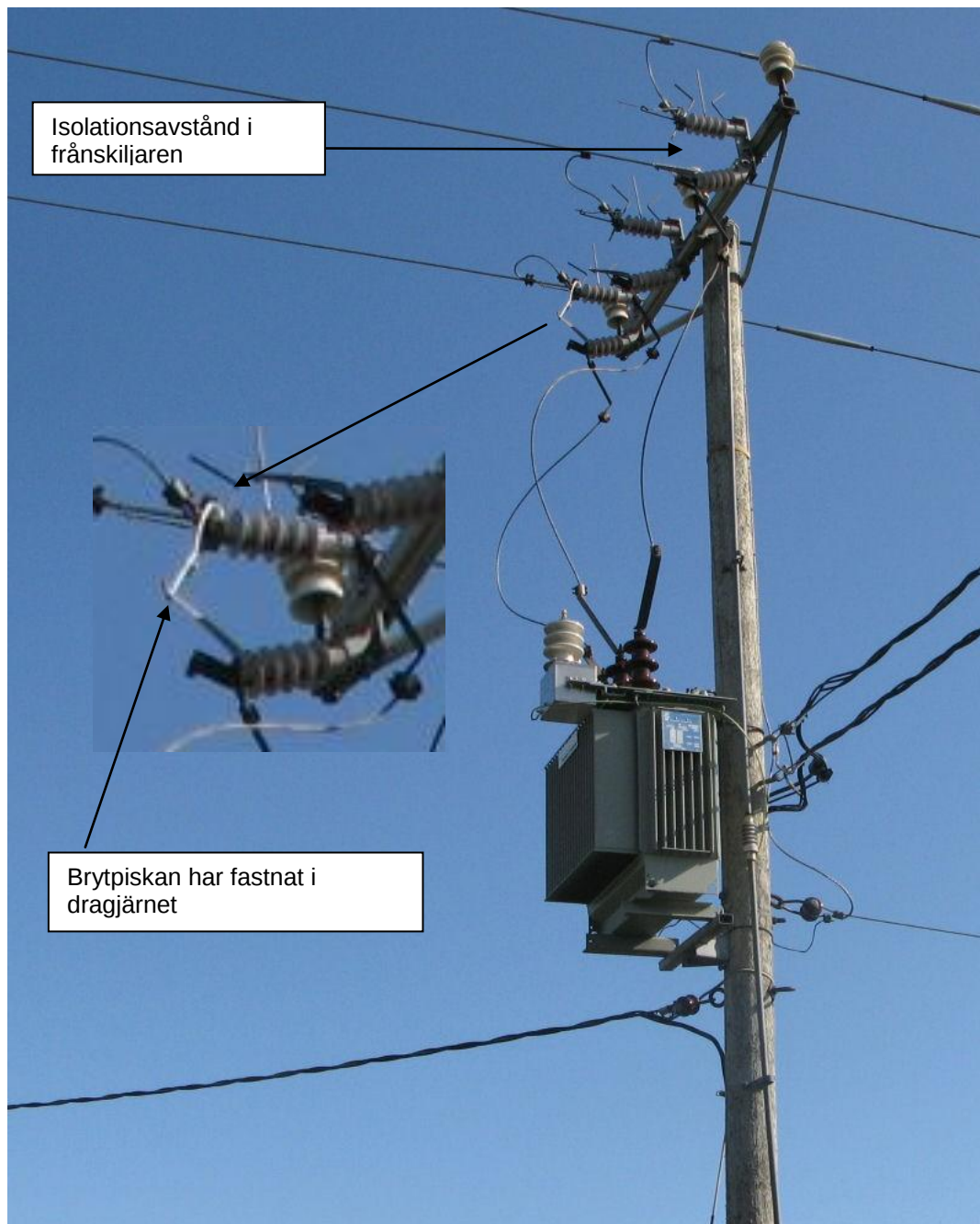
Bild 3. Frånskiljarens brytpiska har fastnat i dragjärnet (Detalj i polisens bild)
