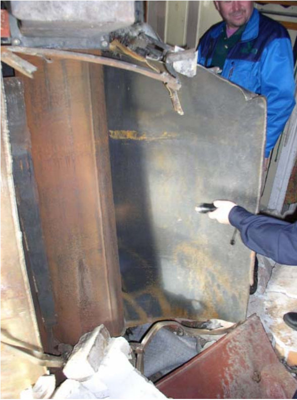
Kuva 1 Kattilan auennut vaippa
