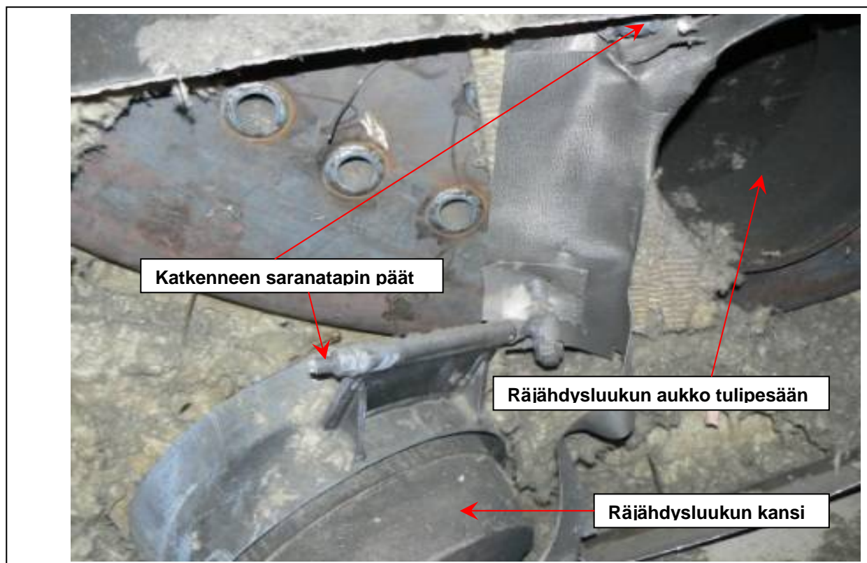
5. Höyrykattilan takapäät ja osittain irtirepeytynyt räjähdysluukku
