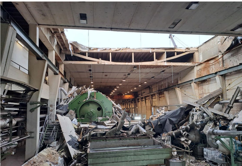
Kuva 6 Tehdasrakennuksen katon sortuma sisältä (Kuva: Tukes)
