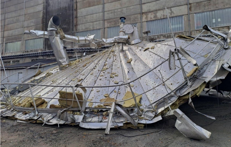
Kuva 5 Massatornin vaurioitunut katto alaslaskemisen jälkeen (Kuva: Tukes)
