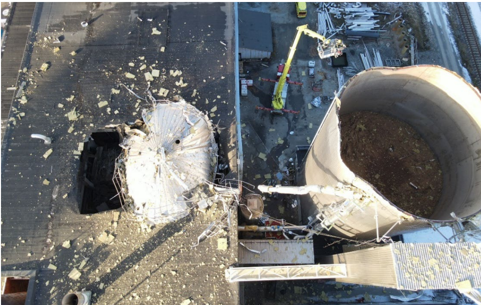
Kuva 4 Massatornin ja tehdasrakennuksen katon vauriot (Kuva: Pohjois-Savon pelastuslaitos)
