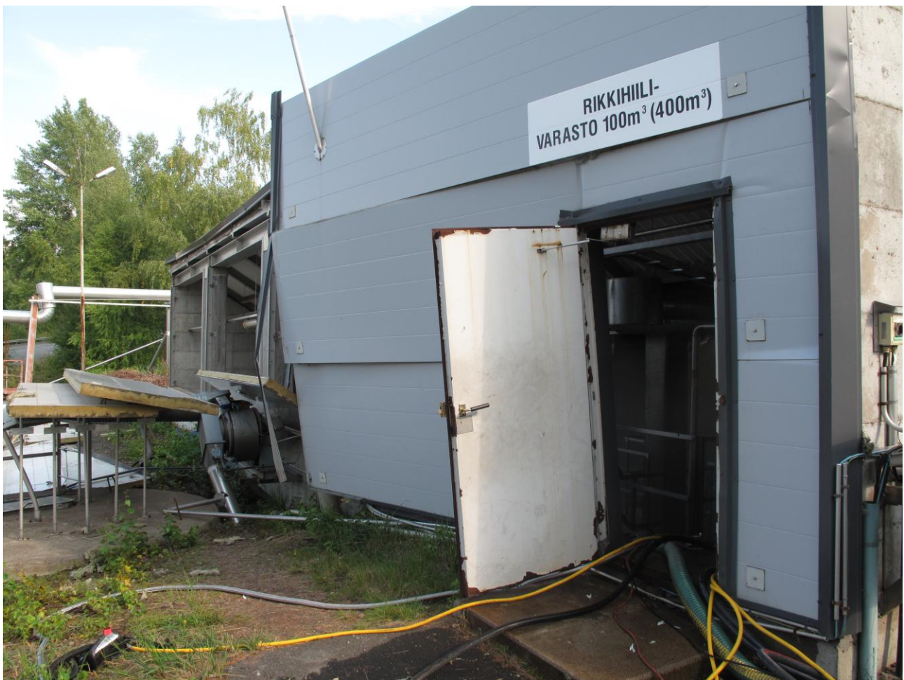
Kuva 6. Räjähdyksen seurauksena paineenpurkauseinä sortui
