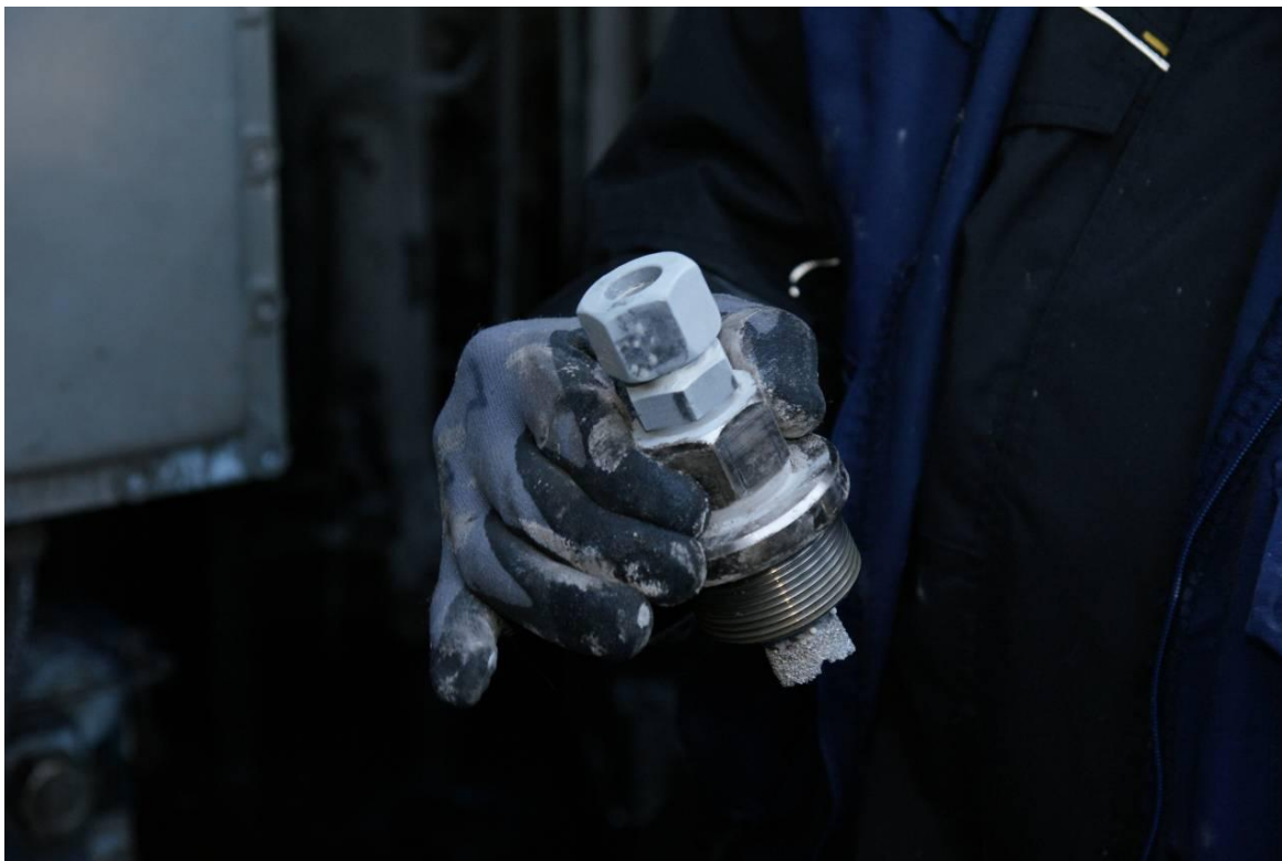
Kuva 4. Maakaasuputken ja kuivainsäiliön välinen liitin
