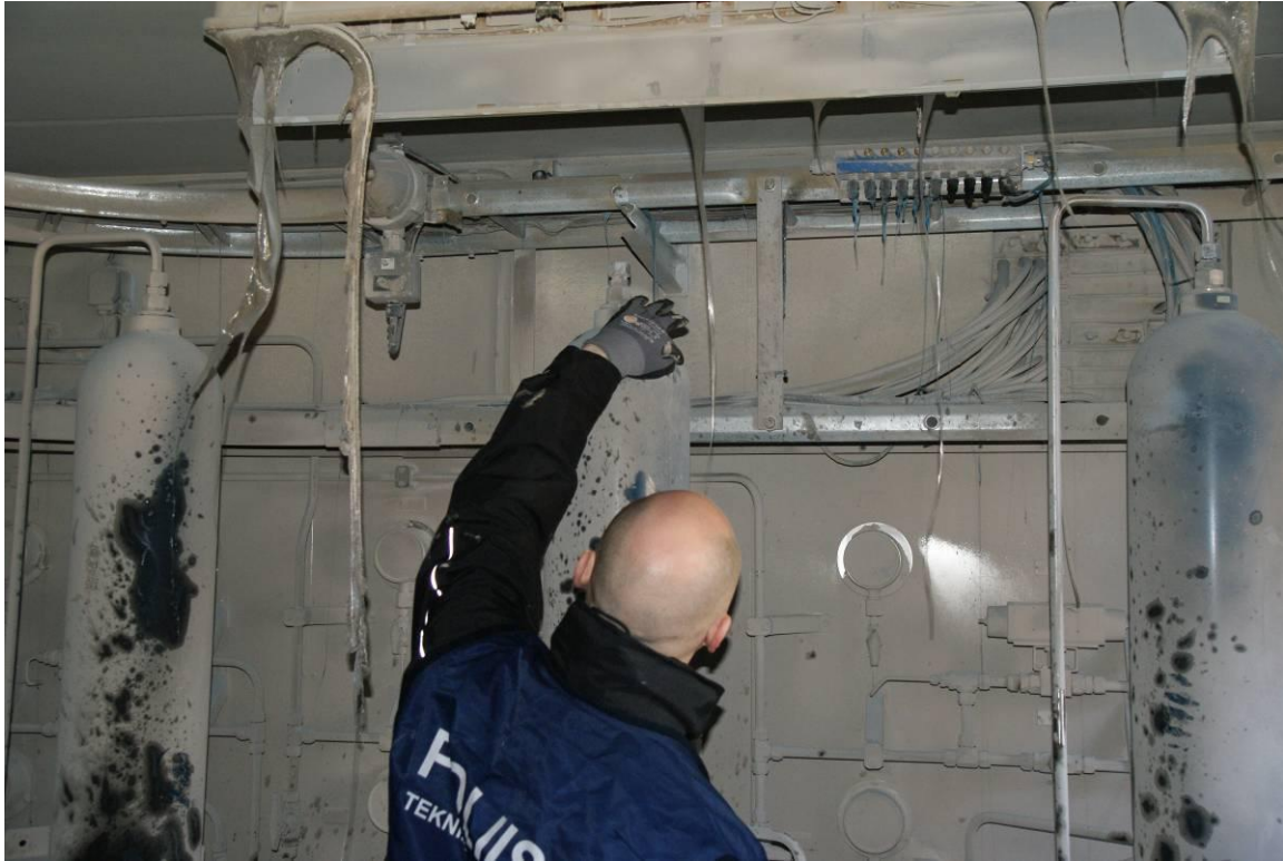
Kuva 3. Kuivainsäiliön ja maakaasuputken välisen liitososan sijainti
