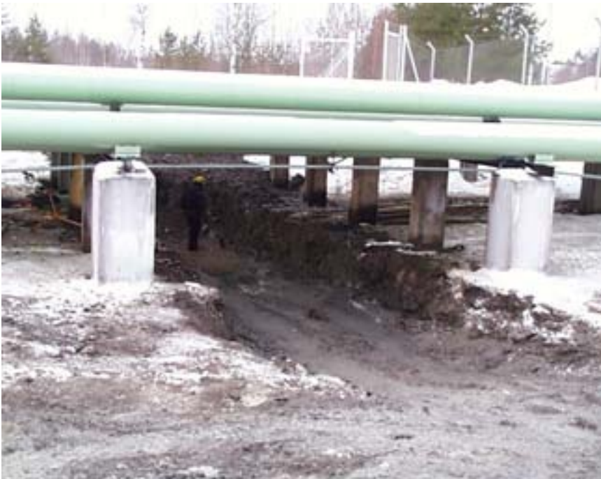
Kuva 6. Putkisillan alapää, johon kaivettiin kuoppa, jotta öljy saatiin paremmin talteen. Osa imeytyi maaperän läpi mereen, ranta on noin 30 metrin päässä.
