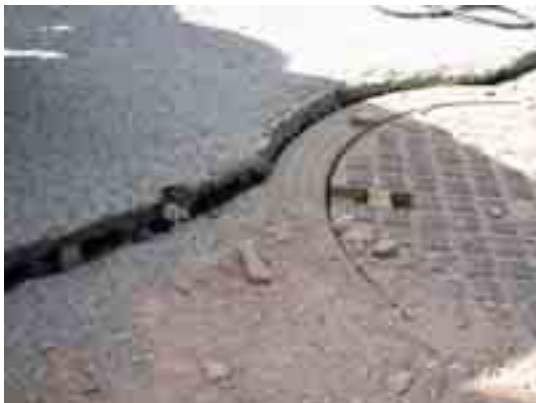
Kuva 6. Jakeluaseman vaurioitunutta asfalttipinnoitetta
