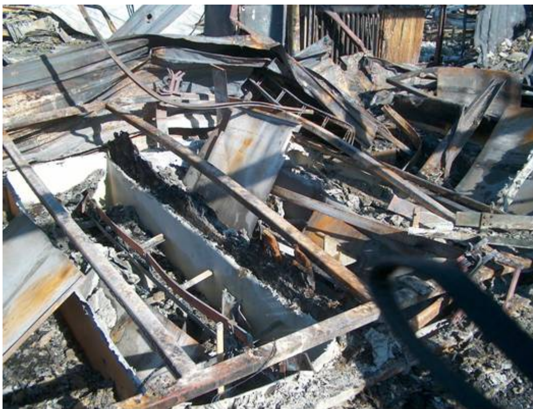
Kuva 2. Sinkkilinjan esipesuallas, josta palo todennäköisesti alkoi.
