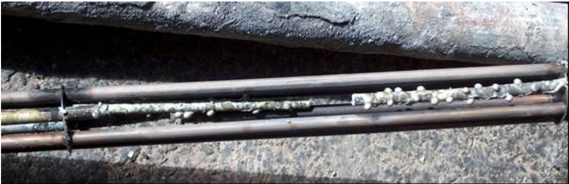
Kuva 3. Sinkkilinjan esipesualtaan yksi uppokuumennin purettuna siten, että sähkövastuselementit näkyvät. Tulipalo alkoi todennäköisesti tästä uppokuumentimesta. Yhdessä vastuselementissä havaittiin merkkejä oikosulusta (maasulusta) ja metallipinnan sulamisesta.
