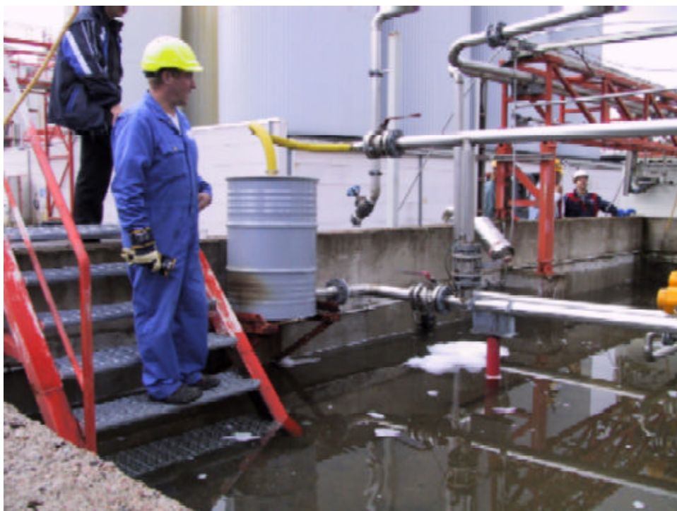
Kuva 3. Aktiivihiihisiuodatin (harmaa tynnyri) ja siitä lähtevät liittännät: alaosaan tuleva metalliputki sekä yläosaan lähtevä kumiletku (kuvassa keltainen). Vasemmassa alalaidassa näkyy aktiivihiihien hehkumisesta aiheutunut mustuma.
