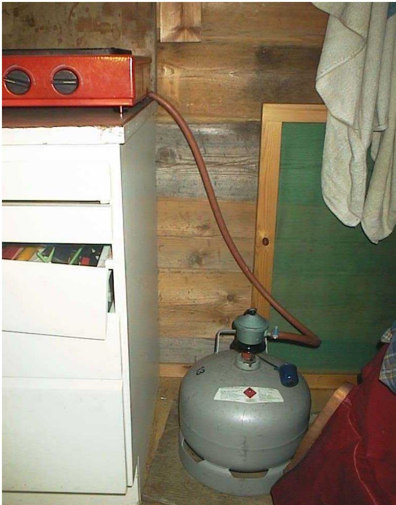
Kuva 2. Viiden kilon nestekaasupullon päässä olevan PV-säätimen käyttövipu oli auki-asennossa
