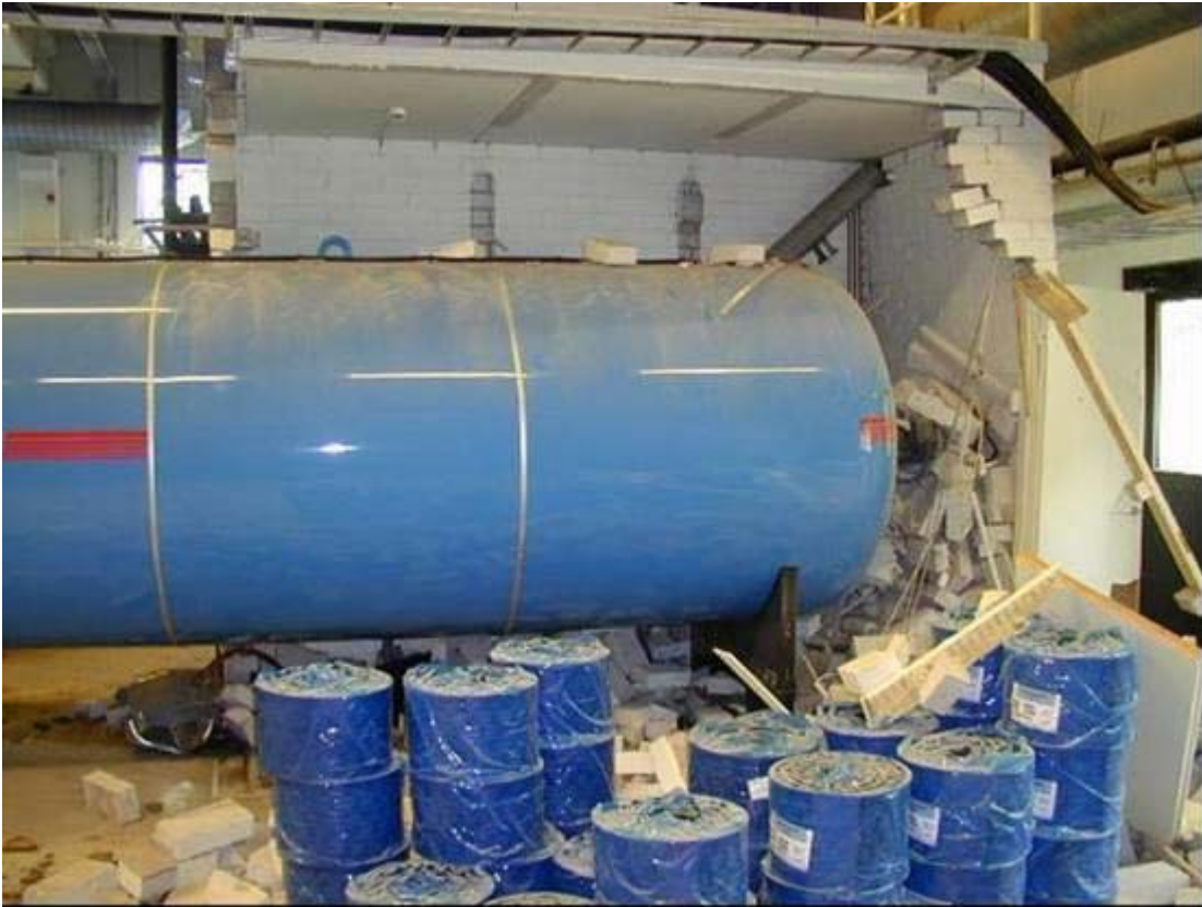
2. Autoklaavi siirtynyt sosiaali- ja saniteettitilojen päälle.
