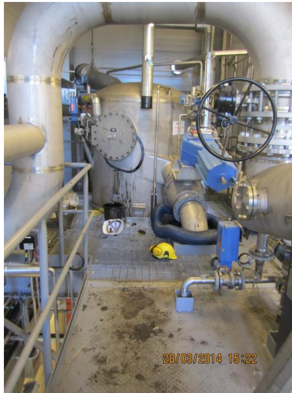
Kuva 5. Välisäiliö onnettomuuden jälkeen
