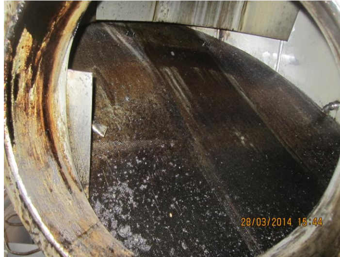
Kuva 4. Välisäiliö sisältä kuvattuna miesluukulta (kuva otettu onnettomuuden jälkeen)
