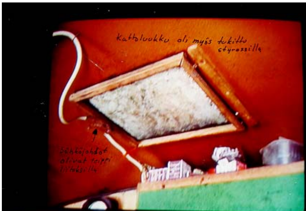
Kuva 2. Kattoluukku oli myös tukittu styroxilla.
