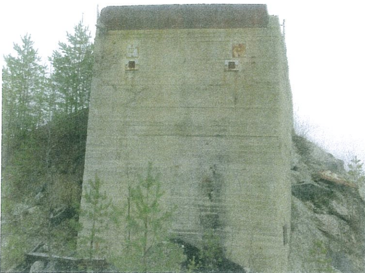
Kuva 7. Murskaamon kippauspaikka ja öljyä sisältävä maa.
