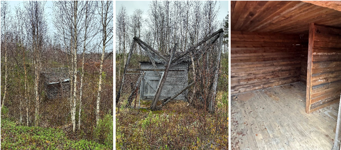
Kuva 8 Vanha Räjähdevarasto, jota ympäröivä verkko on paikoin sortunut
